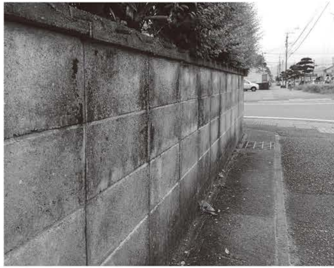
▲通学路のブロック塀
