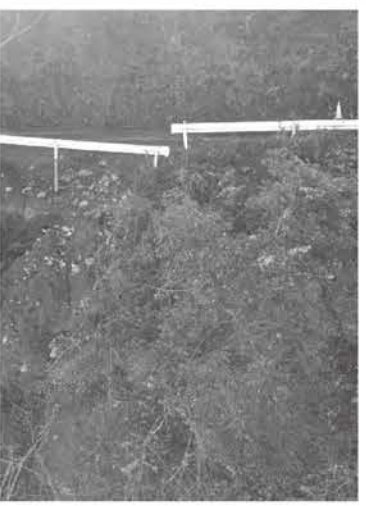
▲ 市内道路の崩落現場
